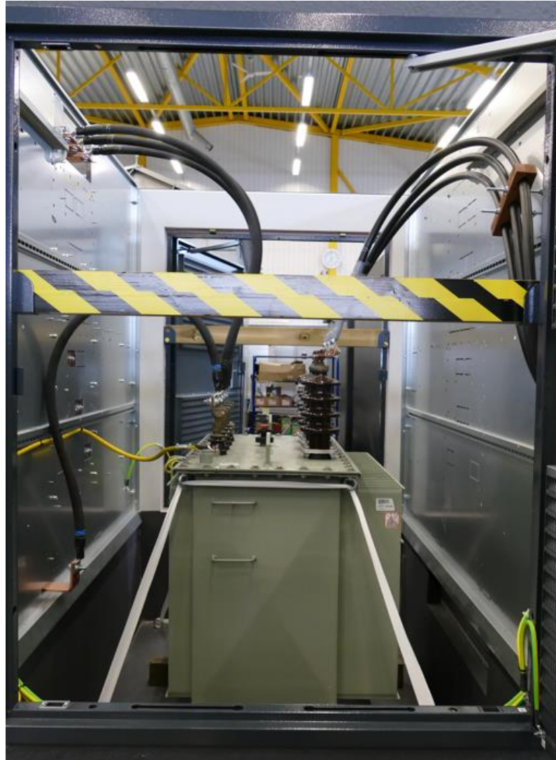
Bild 6. Monterad transformator i nätstationen
