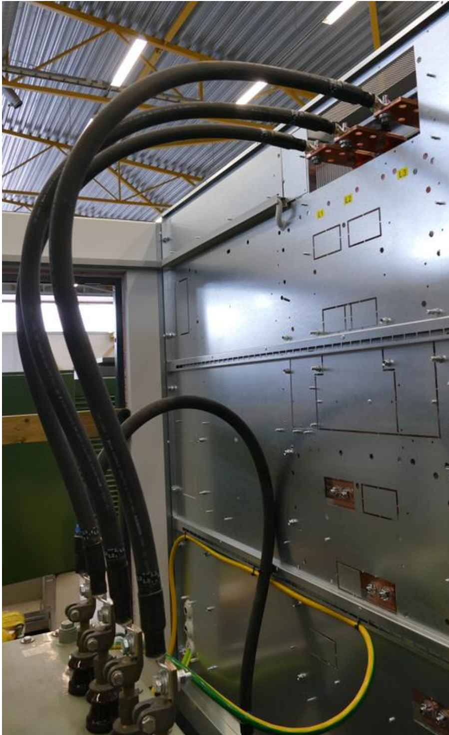
Bild 8. Anslutning av transformatorns LSP-kablar (L1, L2, L3 och PEN)
