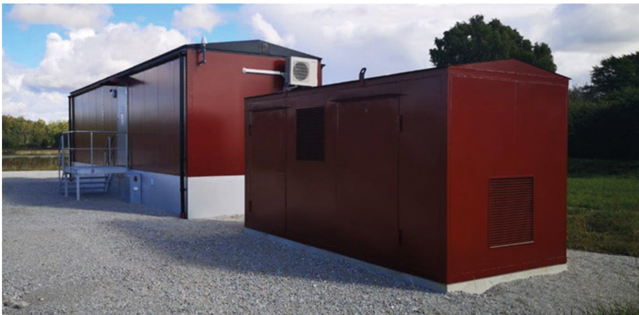
Ny transformatorstation till GEAB, Gotlands Energi, vid Stenbro på Gotland.
