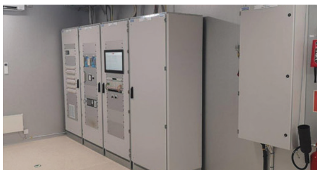
Kontrollskåp och lokalkraftcentral.
