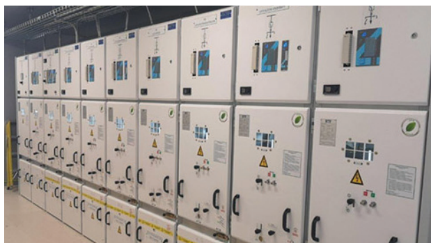
Mellanspänningsställverk, SNC 10 kV.
