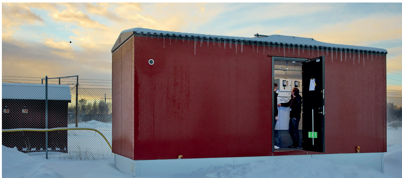
Teknikhus med mellanspänningsställverk och batteriutrustning från Harju Elektek. Fördelning från Boden Energi i bakgrunden.
