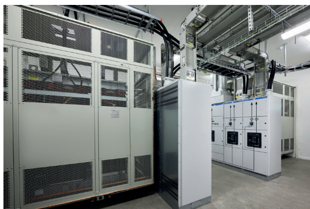
Ett av tre transformatorrum med två transformatorer och tillhörande lågspänningsställverk för ventilation och serverdrift.
